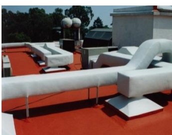
Ductos de Aire
